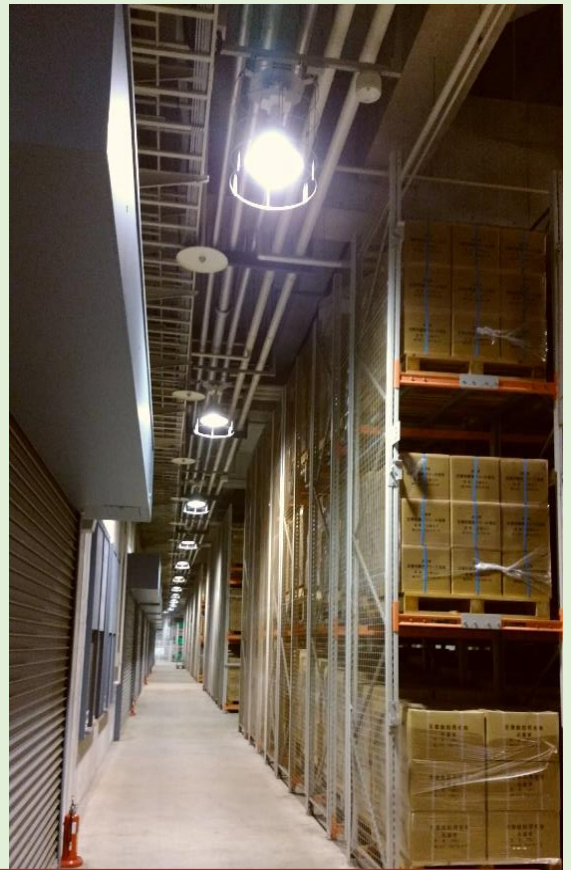
災害に備えての備蓄倉庫は 「兵庫県立三木総合防災公園陸上競技場」の バックスタンドと、サイドスタンドの下に設置 (兵庫県広域防災センター)
